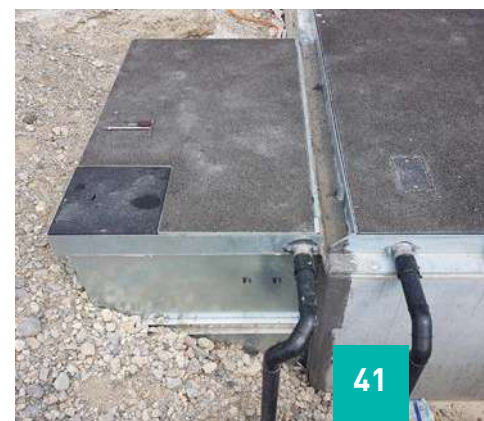
Entwässerungs-Rohre, Technikerschacht und Plattform
