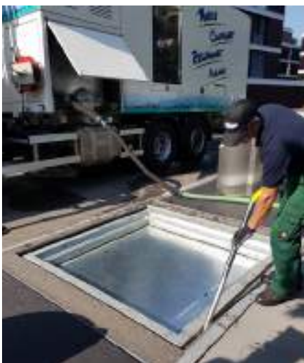
Aspiration des impuretés résiduelles telles que l'eau et les feuilles mortes.
