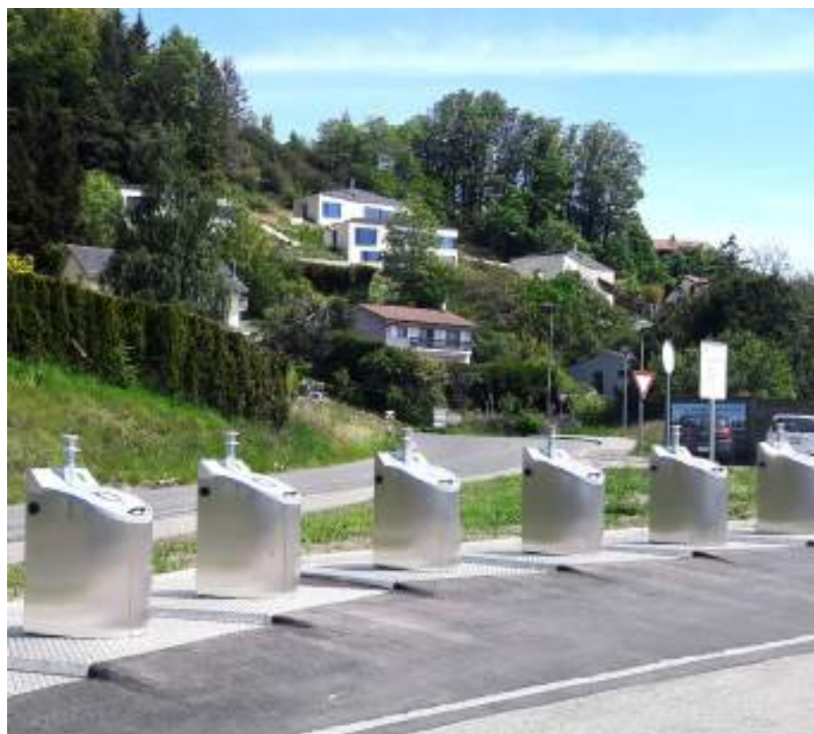
Station d'élimination avec des colonnes Vilaro 120 et système d'accès Vident-Basic.
