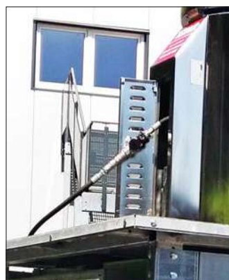
Raccordement hydraulique à des véhicules externes
