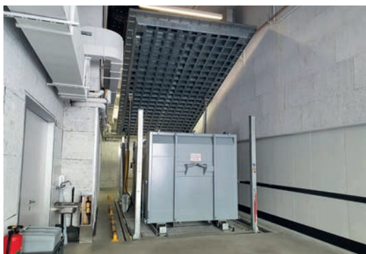
Sollevatore alzato per il caricamento del compattatore.
