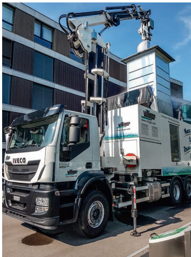
Lavaggio automatico di un contenitore interrato nella unità mobile di lavaggio.
